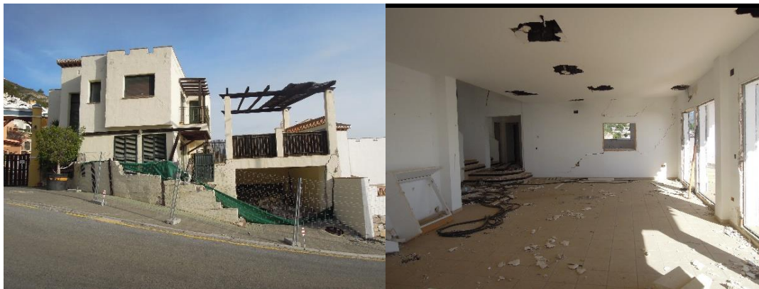
Fig. 16. Daños estructurales graves a las viviendas por el movimiento de la ladera. En el año 2015 se declaró el Estado de Emergencia
